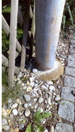
wenig Rost im Erdbereich
