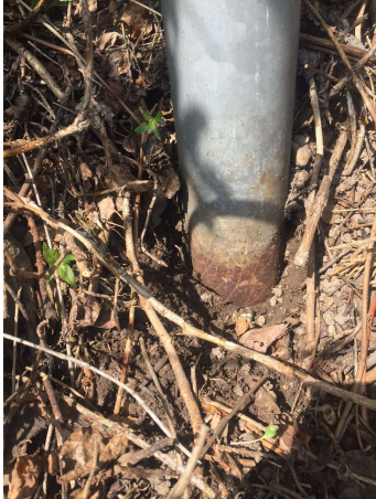
Starker Rost im Erdbereich
